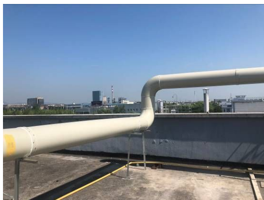
废气收集管道
