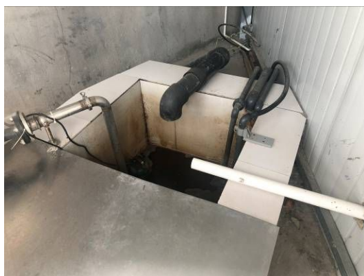
污水站排放口
