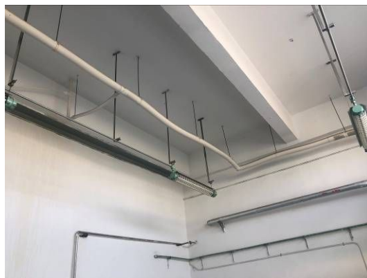
废水管道架空
